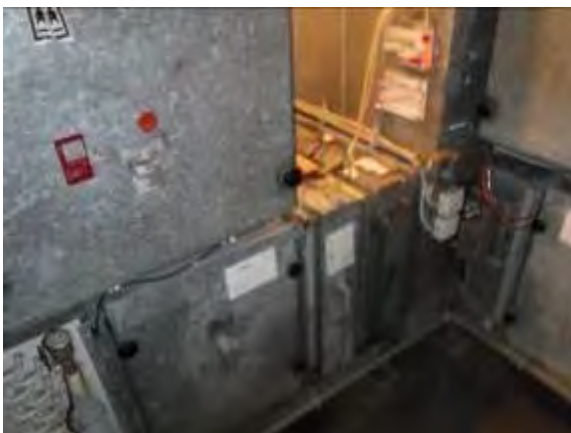
IV-koneiden säätölaitteet ovat uusittu vuonna 1995.
