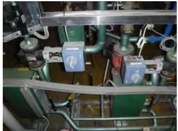
Lämpötiloja säädetään normaaleilla kaukolämmön ensiöpuolen 2-tieventtiileillä.
