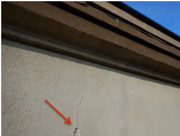
Kuva 3.12 Arviolta alustan liikkeistä aiheutunut halkeama eteläpäädyssä
