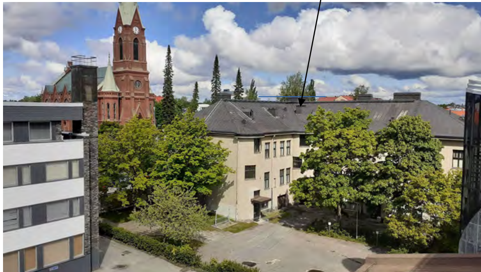
IV-laitteiden pääteyksiköitä katolla
