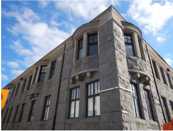
Kuva 3.20 Julkisivun luoteiskulma, saumoissa rapautumaa
