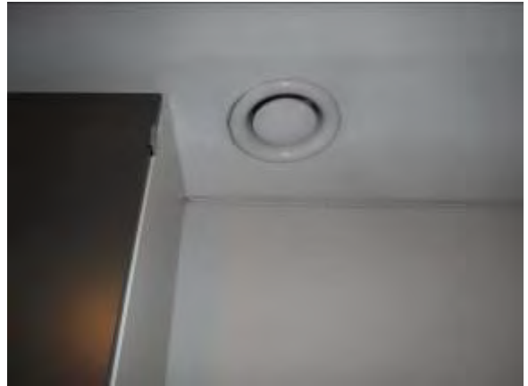
Päätelaitteet ovat koneelliseen ilmanvaihtoon tarkoitettuja malleja.
