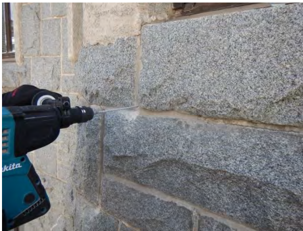
Kuva 3.32 Saumalaasti kostea ikkunan alapuolella
