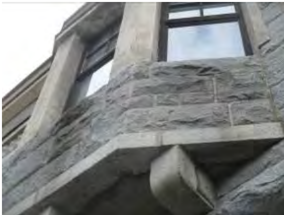
Erkkerissä on ollut kosteusongelmaa.
