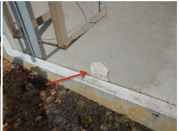
Kuva 3.13 Rappaus on irronnut alaosasta eteläpäädyssä
