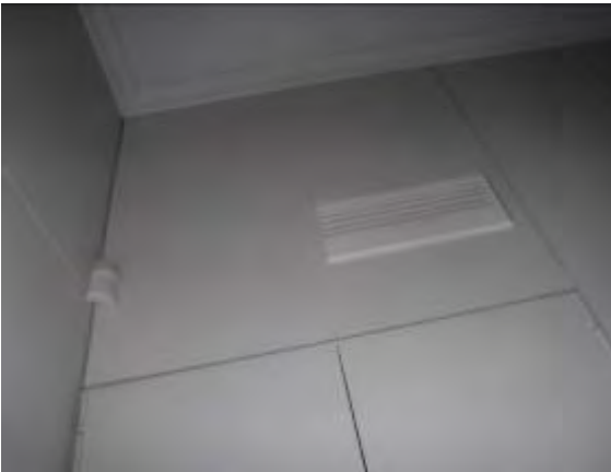
Yksittäisiä päätelaitteita oli uusittu
