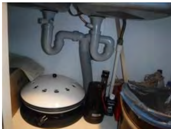
Kylmävesijohto tulee sinkityllä teräsputkella kalusteilla asti.
