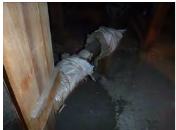
Tuuletusviemärin eristys puuttuu lyhyeltä kohdalta ullakolla
