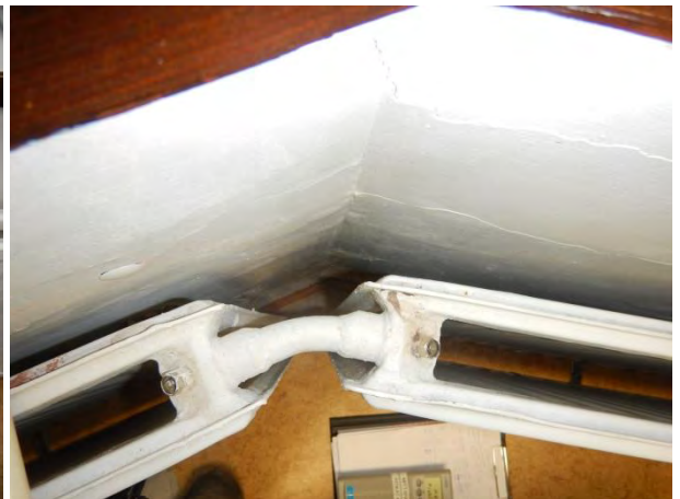
Kuva 3.23 Tilan 232 erkkerin seinän tasoite irtoilee
