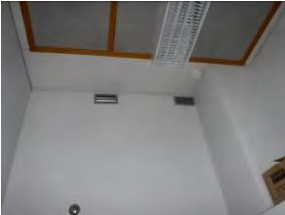
Toimistossa tulo- ja poistoilmasäleiköt
