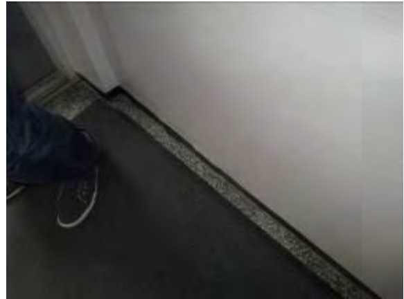
Päädyn kosteusvaurioitunutta, korjattua seinäpintaa, hieman kupruilua on.
