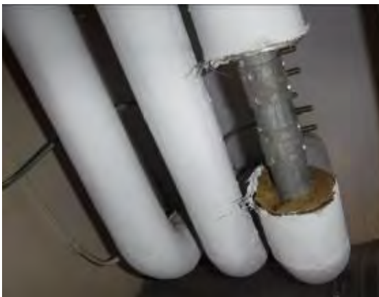
Eristeet sisältänevät asbestia.
