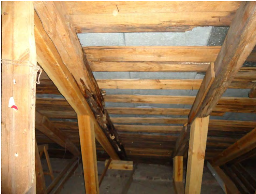
Kuva 14. Lahonneita ja vahvistettuja vesikaton puurakenteita Hallituskadun puoleisella lappeella.
