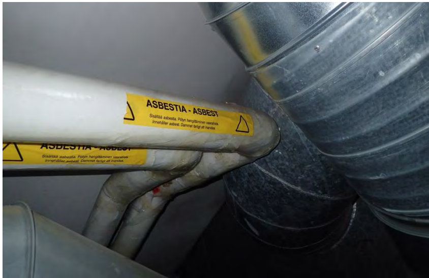
Kuva 17. Putkien eristeenä asbestia sisältävää materiaalia IV-konehuoneessa.
