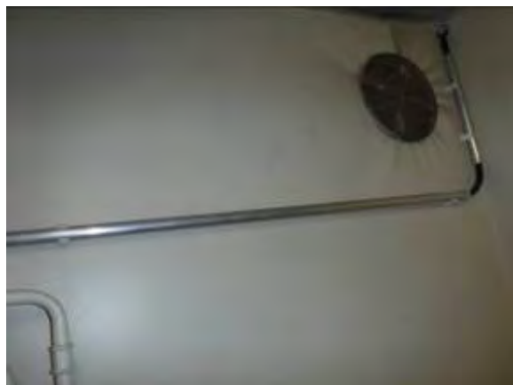
Kellarin koneellisen poiston alueilla on korvausilmaventtiilejä.
