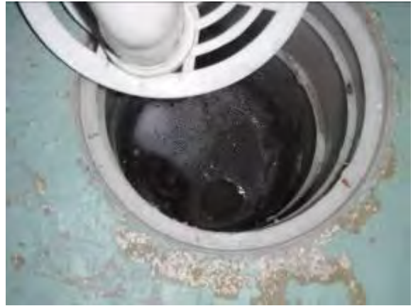
Lattiakaivot ovat pääosin valurautaisia.
