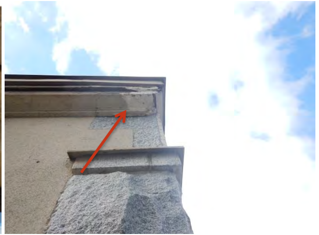
Kuva 3.17 Koilliskulmassa räystäsuloke vaurioitunut
