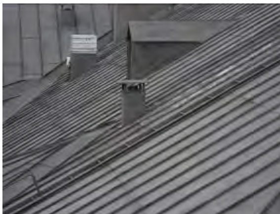
Painovoimaisen ilmanvaihdon hormien päissä on sadehatut
