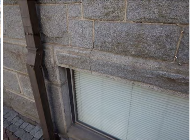
Kuva 3.31 Ikkunan yläpuolinen kivi on haljennut
