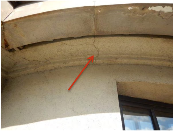
Kuva 3.16 Räystäsulokkeessa halkeamia sisäpihan nurkassa
