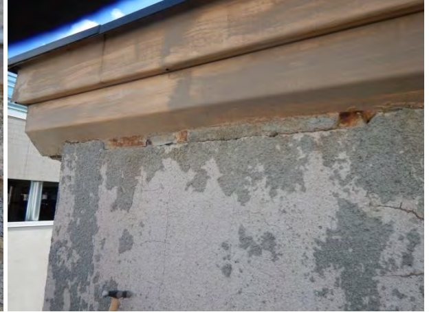
Kuva 3.27 Vesilipan yläpuolinen rappaus on paikoin halkeillut ja rappaus irti alustasta
