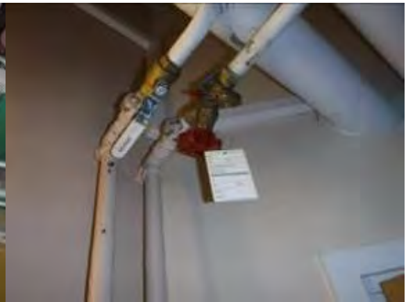
Linjaventtiilit ovat uusittu venttiilien merkintöjen mukaan vuonna 1995.
